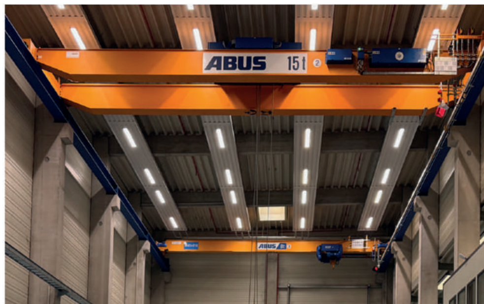
Kransysteme: 8-t-Kran mit 38 t Kapazität
